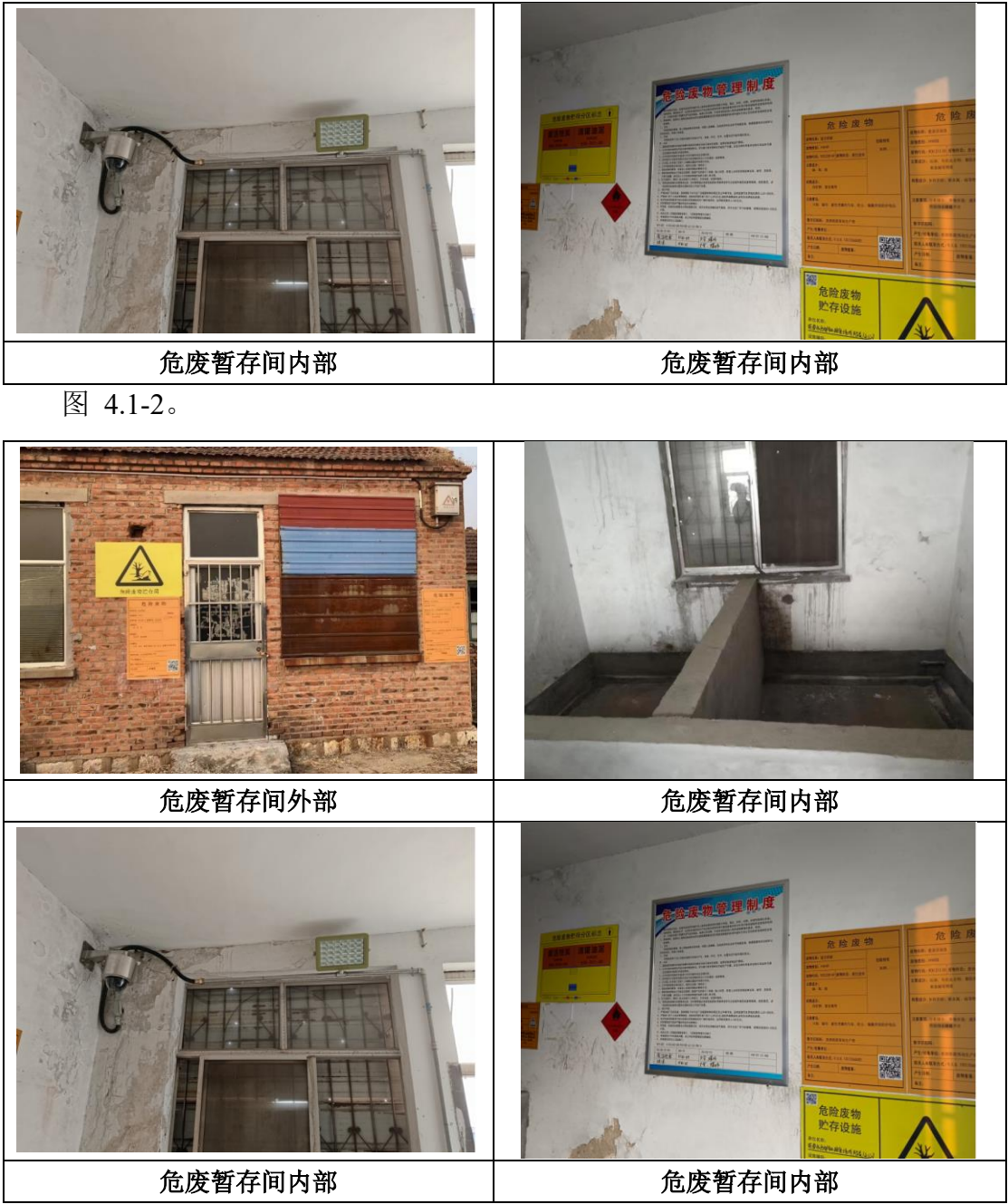
图 4.1-2 危废暂存间现场照片
