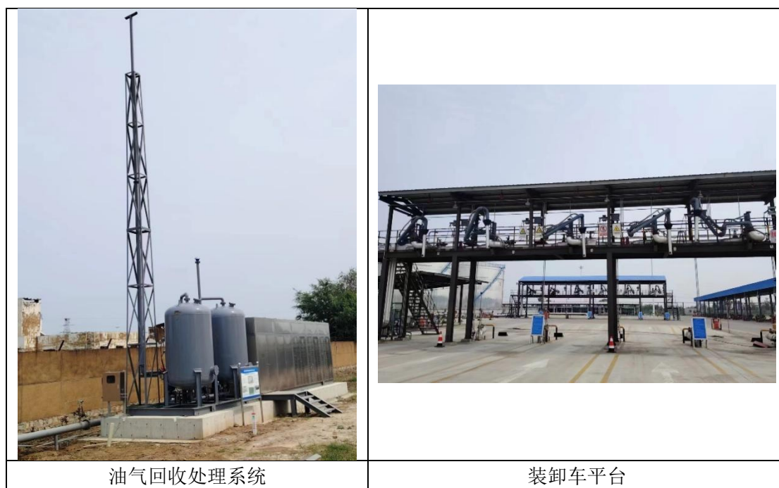
图 4.1-1 废气治理设施照片
