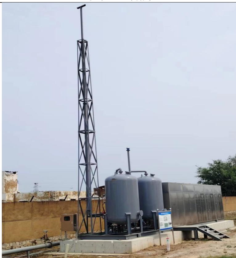
冷凝+活性炭废气处理装置
