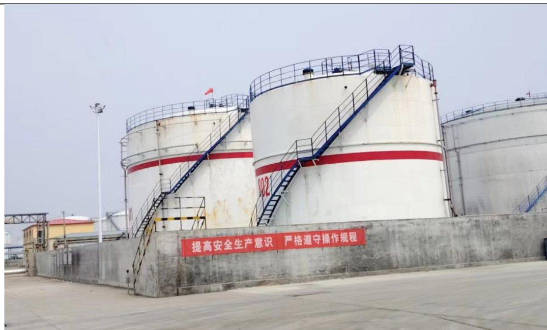
甲醇、乙醇储罐
